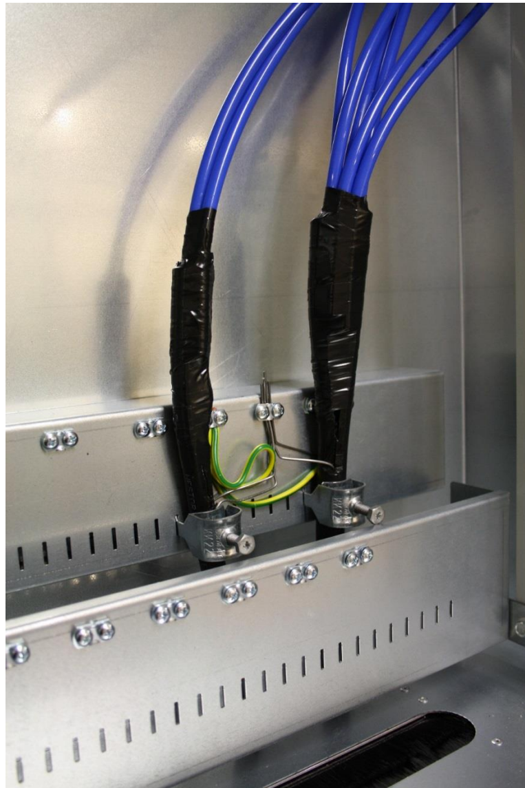
Kuva 22. Flex-maavalokaapeleita asennettuna jatkoskaappiin.
