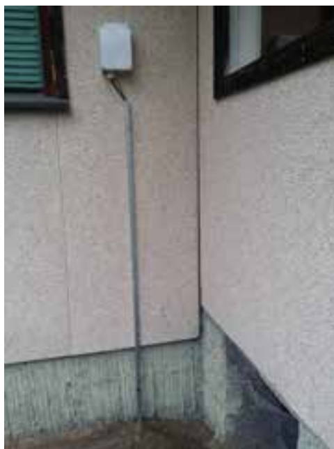
Kuva 7.36. Talokaapeli suojattu talon seinustalla maasta lähelle ulkopäätettä (Kuva: Nordic Tele Service Oy).
