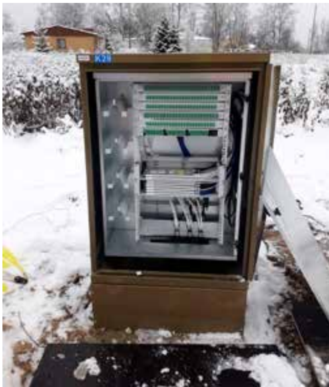
Kuva 6.8. Jaottimia sijoitettuna ulkoristikytkentäkaappiin (Kuva: Televerkkopalvelut Seppo Marttila Oy).
