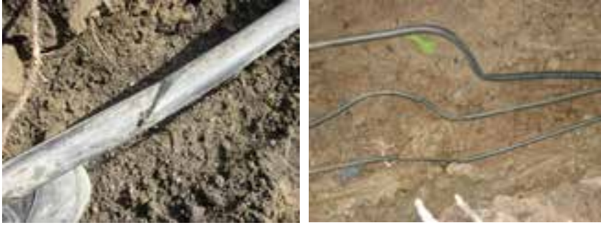
Kuva 10.3. Esimerkkejä asennusten yhteydessä kaapeleihin tulleista vioista (Kuvat: Elisa Oyj).
