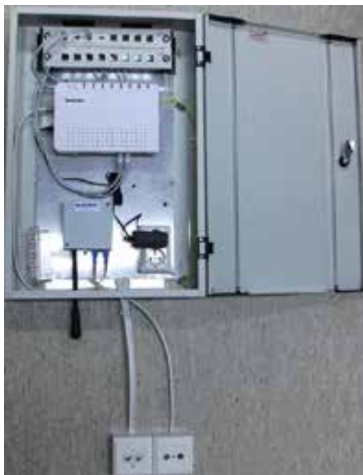
Kuva 4.25. Kotijakamon kaappi (Kuva ElmoNet Oy).
