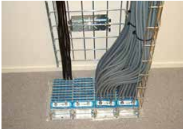
Kuva 8.22. Palokatko asettaa haasteita kaapeloinnille (Roxtec).
